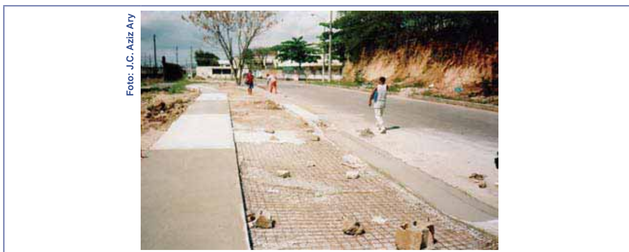
FIGURA 153 - Reforço da base do pavimento em área de cruzamento de veículos sobre a ciclovia em construção em Campo Grande/RJ.
