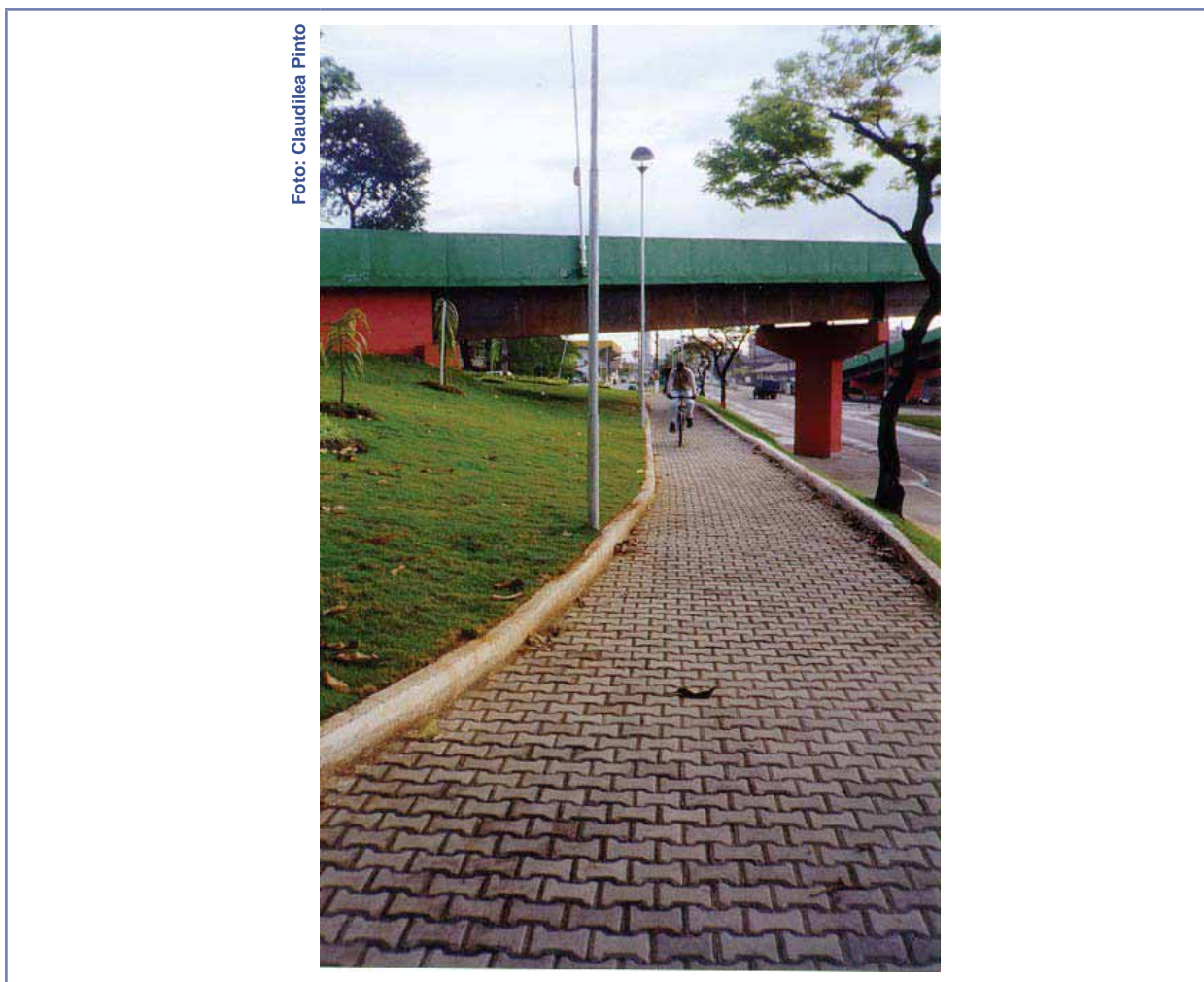
FIGURA 159 - Pavimentos de ciclovias com blocos pré-moldados de concreto em Volta Redonda/RJ.
